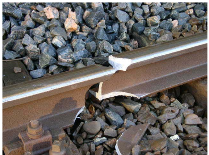
Ernstige schade aan het spoor als gevolg van een ontsporing. Het hoeft niet iedere keer zóver te komen om zinvolle informatie over veiligheidsgebreken te achterhalen!
